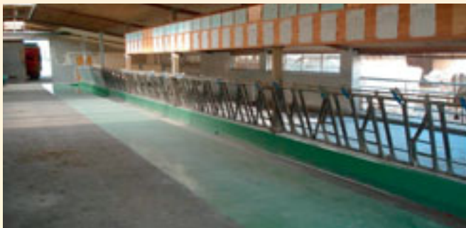
Mit der Erweiterung der Fressplätze im Gutsbetrieb Salez wurde die letzte Etappe baulicher Massnahmen im Rindviehstall abgeschlossen.
